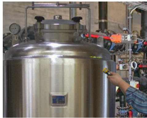
Регистрация разгерметизации резервуара с помощью флуоресцентного концентрата Н 849
